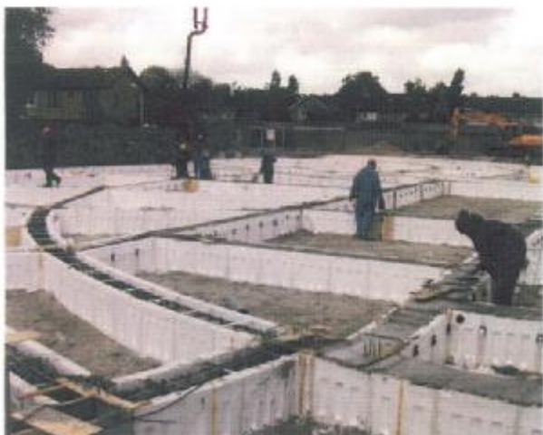
Door de EPS-funderingskisten te versnijden en te kitten kunnen ook ronde vormen worden gemaakt.
